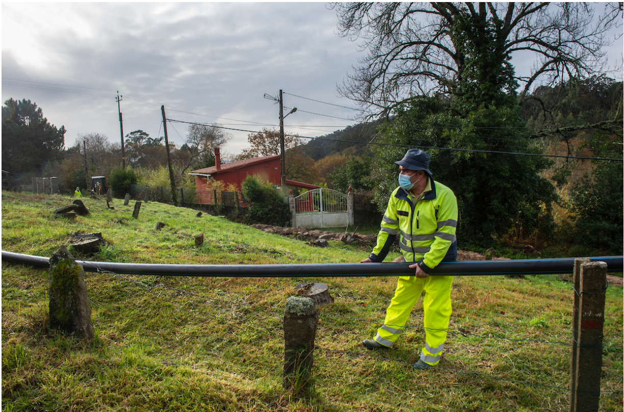
Operarios de UTE Gestión Cangas finalizaron esta semana as obras de saneamento en Donón | M. Riopa PUNTO GA
